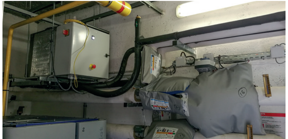
Fig. 3 : Le prototype installé dans la chaufferie.
